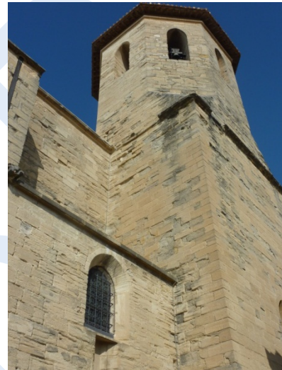
Morphologie de dégradation de la « Pierre du Midi » par desquamation en plaques (façade et clocher de l'église Saint Maurice de Caromb, 84, ph. J.Berthonneau).
