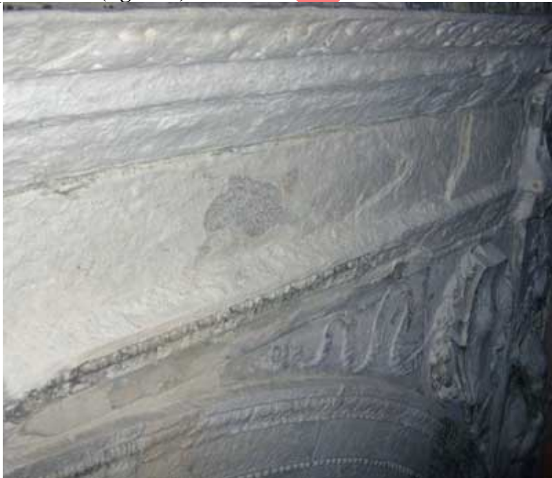
Figure 4 : superposition de plusieurs desquamations successives dites en « pelure d'oignon » sur la frise portant la dédicace à Saint Lazare.
