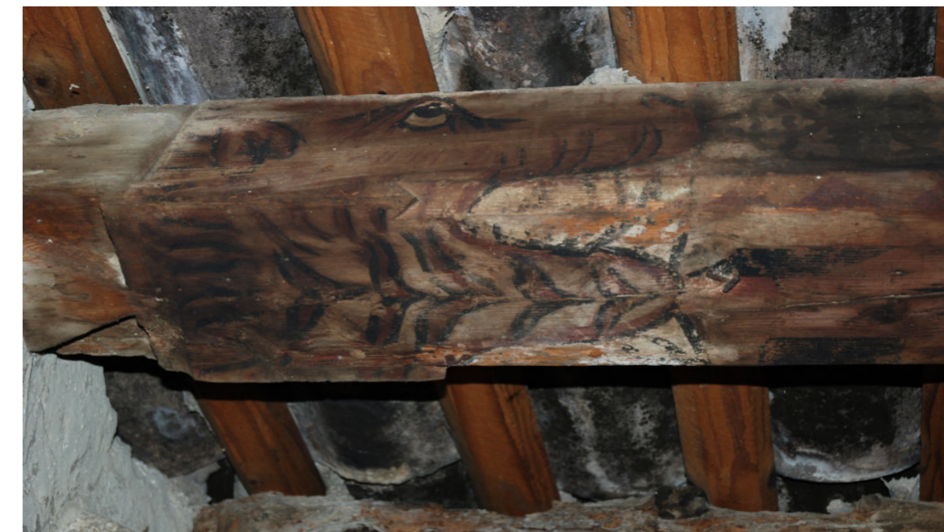
Maison dite de la Reine Jeanne, Sorgues : détail d'anciennes pièces de charpente peintes de l'ancien logis, remployées dans un autre corps de bâtiment. Photo : CICRP - J.-M. Vallet.
