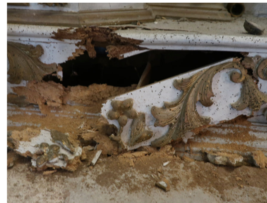
Retable de l'église de Valbelle (détail) : un exemple des ravages de la petite vrillette. Photo : CICRP - F. Fohrer.
