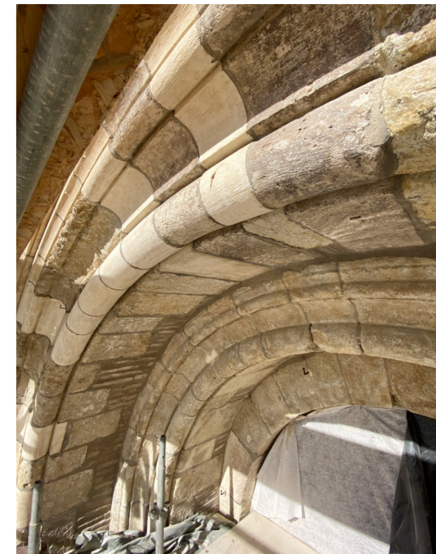
Basilique Saint-Sernin, Toulouse : variété des types de pierres (et briques) dans les voûtures du portail occidental. Photo : CICRP - P. Bromblet.
