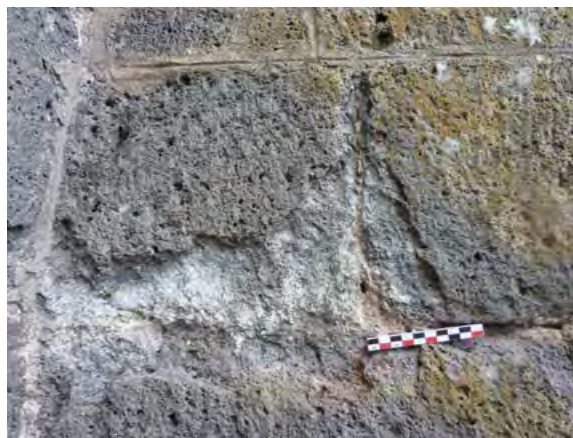
Cathédrale Saint-Etienne, Agde : cristallisations salines à l'origine d'une desquamation en plaque du basalte.
