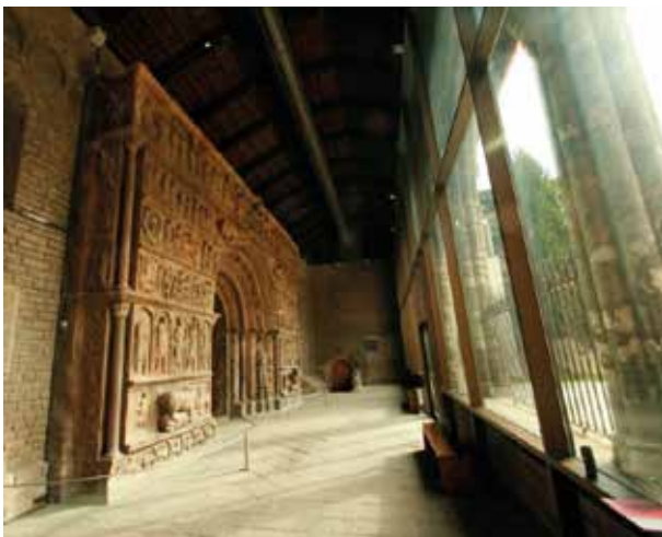
(fig. 5) Installation d'un système de climatisation, de refroidissement, de déshumidification et de filtrage de l'air avec sondes mixtes d'humidité et de température contrôlées à distance.
