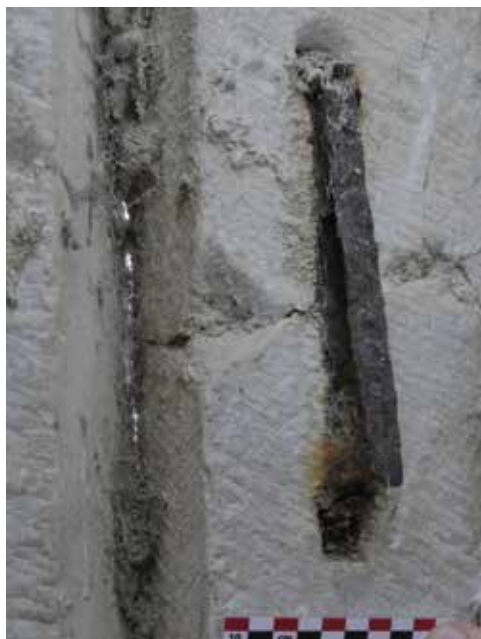
(fig. 6) Détail de l'agrafe du relief droit, côté ouest : le fer est complètement coupé par l'oxydation au niveau de son coude inférieur.
