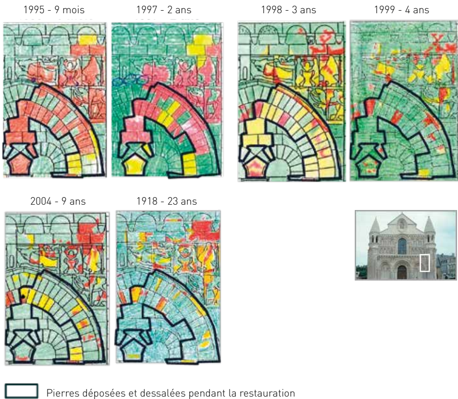
(fig. 3) Bilan du dessalement : négatif à court terme, puis une lente évolution vers une certaine stabilisation. Les pierres soulignées en noir ont fait l'objet d'une dépose avant dessalement.
