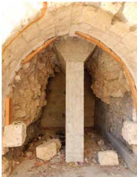
(fig. 10) Vue de la cavité creusée dans le piédroit de droite avec son pilier de béton, 2018.
