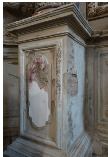
Dégradation du retable dans la zone des remontées capillaires. Photo : CICRP - P. Bromblet.
